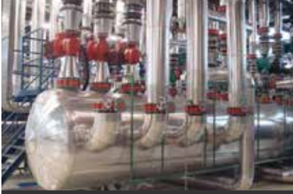
Isıtma Sistemi Heating Installation
