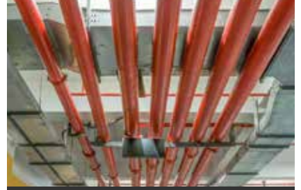
Yangın Tesisatı Fire Protection Installation
