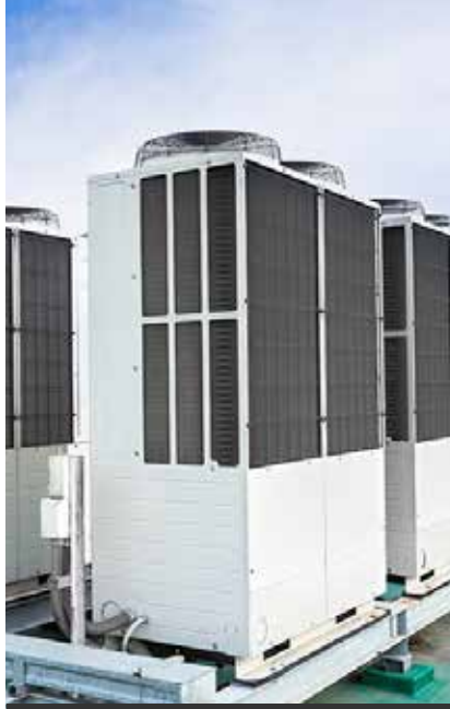
İklimlendirme Tesisatı Air Conditioning Installation
