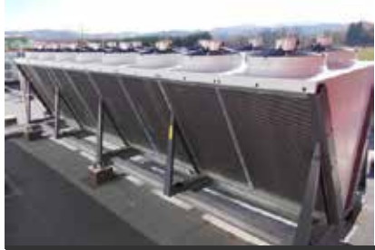
Soğutma Sistemi Cooling Installation
