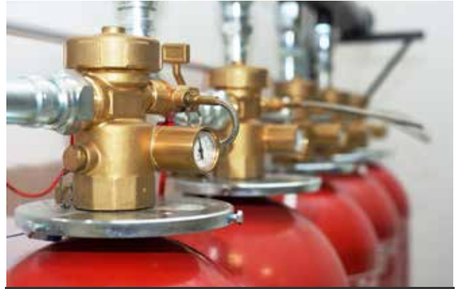
Gazlı Söndürme Tesisatları Gas Extinguishing Installation
